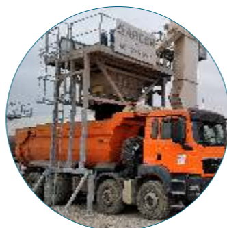
Tolva de descarga
